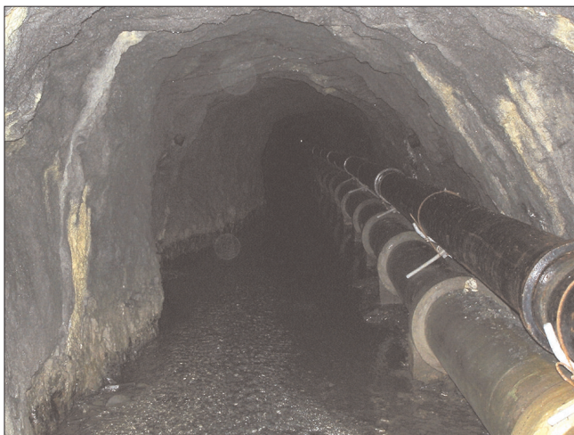
L'intérieur du tunnel avec les eaux de ruissellement de la vallée de l'Ertenze et les conduites transportant l'une, les eaux de source, l'autre l'eau du barrage de Zeuzier.
